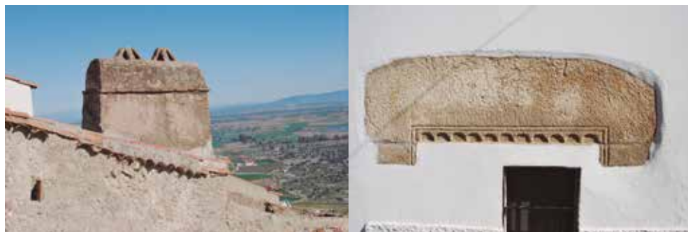
Chimenea típica de la calle Bustos y dintel decorado de la calle Enrique Ramírez
