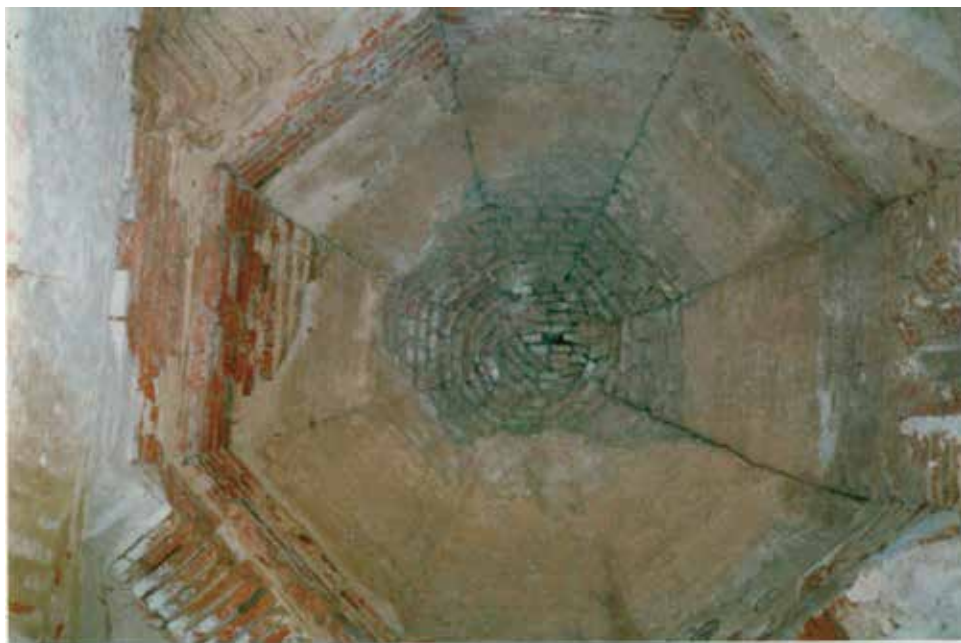
Fortaleza. Bóveda esquifada de la torre de acceso en recodo al castillo. Estado antes de la restauración
