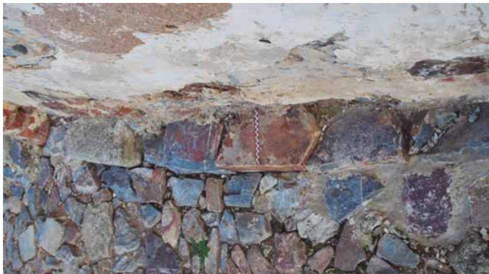
Base del muro sobre el que cimienta la fachada de la nave de la antigua parroquia del castillo de Magacela
